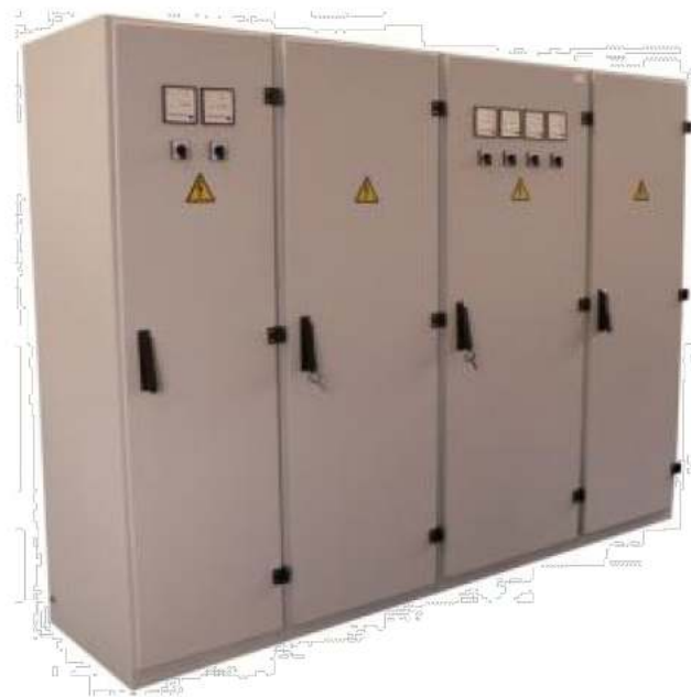
Измерение на вводе панелей ГРЩ
