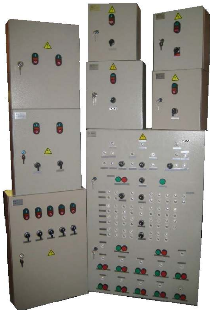
Щиты автоматики и управления
